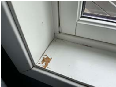
Skade på vinduskarm i soverom.
