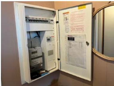
Sikringskap står i entre
