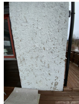
Stedvis behov for lokale utbedringer.
