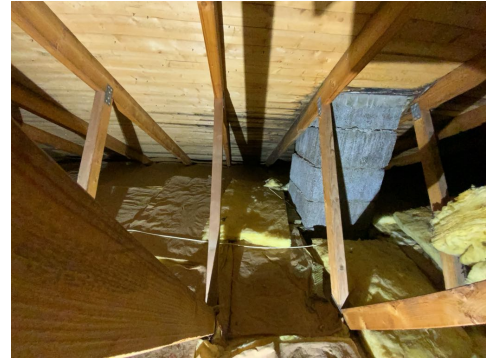
Synlige skader rundt pipeløp etter tidligere skader før taktekket ble skiftet i 2014 iht. eiers opplysninger.
