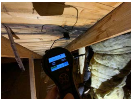
Ingen høy fuktprosent ved fuktmålinger på befaringsdagen.
