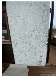
Stedvis behov for lokale utbedringer.
