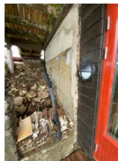
Stedvis behov for lokale utbedringer.
