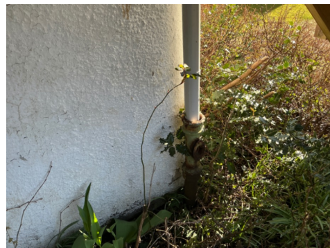
Eldre nedløp i grunnen av støpejern.
