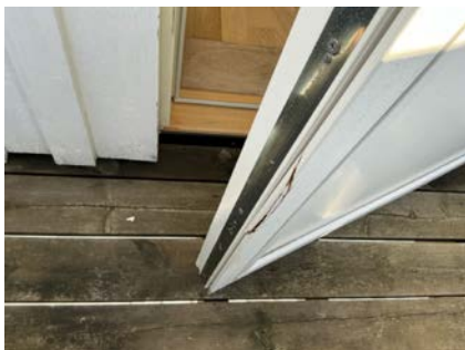
Litt skade på balkongdør oppe.
