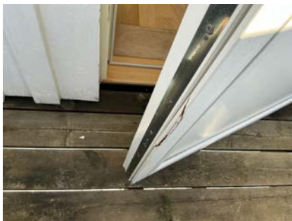
Litt skade på balkongdør oppe.
