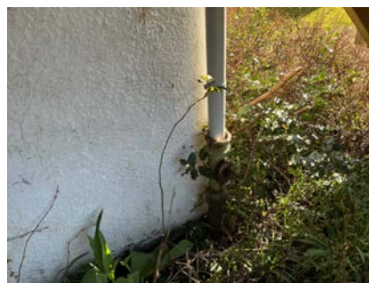
Eldre nedløp i grunnen av støpejern.
