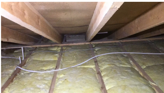
Mangler luftespalte i nedkant
