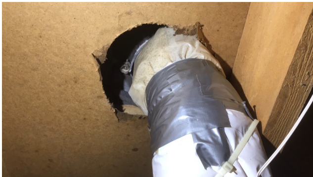
Utettheter rundt gjennomføringer
