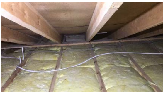
Mangler luftespalte i nedkant
