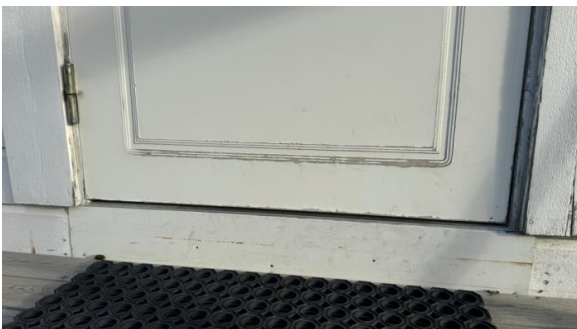
Ytterdøren er utvendig værslitt.
