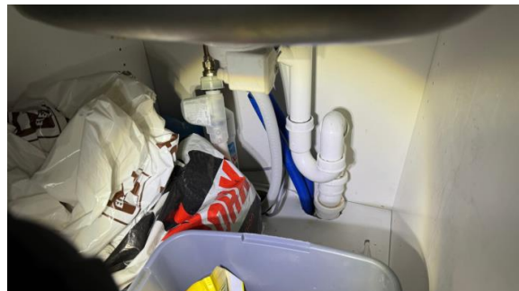
Det mangler tettemuffer i enden av varerør på rør-i-rør-system.
