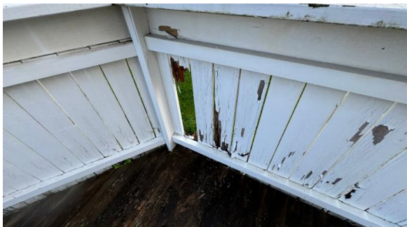
Det er råteskader i rekkverk.
