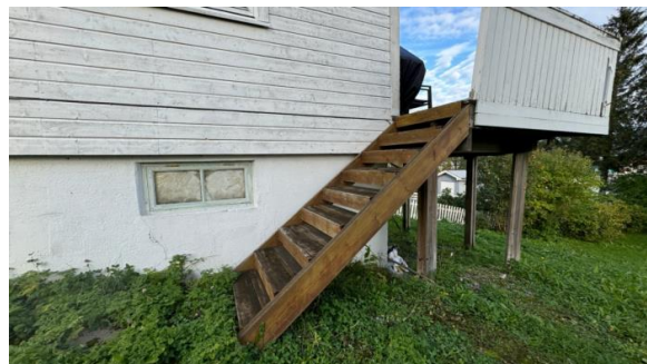
Trappen mangler rekkverk.
