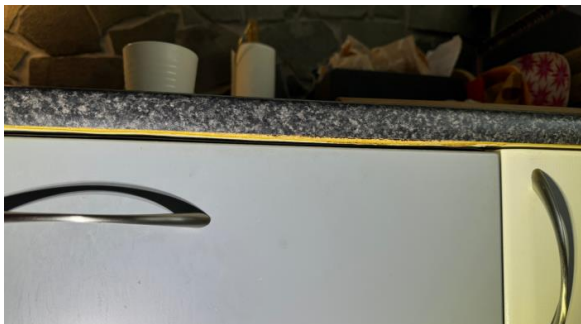
Fuktsvell i benkeplate.
