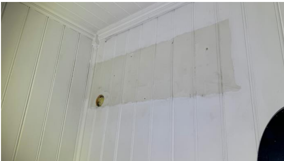
Merker etter varmpumpe på veggen i stuen.
