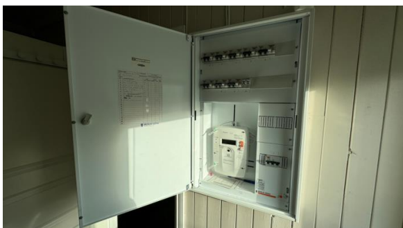
Kontroll av el-skap og kursfortegnelse.
