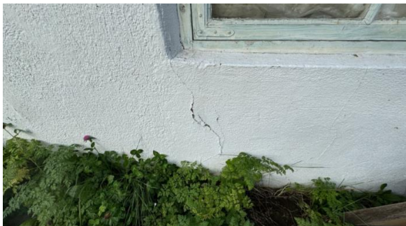
Stedvis sprekker i grunnmuren.
