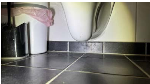
Det er ikke påvist tilfredsstillende løsning for å synliggjøre lekkasje fra innebygget sisterner.
