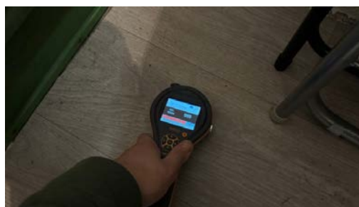
Det er påvist indikasjoner på noe fuktgjennomtrenging i kjellergulv.
