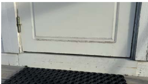
Ytterdøren er utvendig værslitt.
