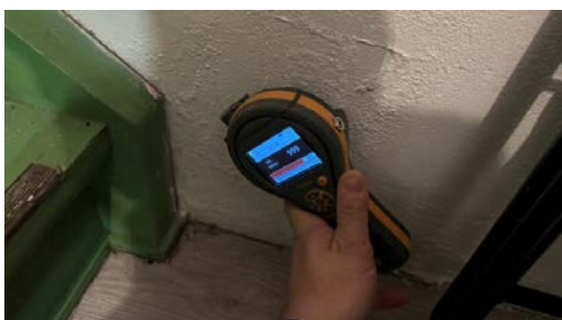
Det er påvist indikasjoner på noe fuktgjennomtrenging inn i kjellermur.
