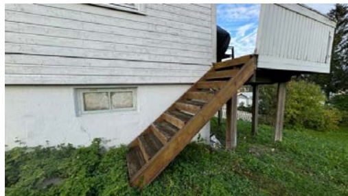
Trappen mangler rekkverk.
