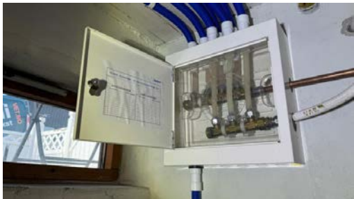
Rørkursene på rør-i-rør systemet på vannledninger er ikke merket.
