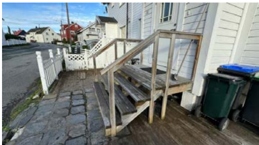
Åpninger i rekkverket er for store.
