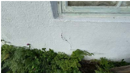
Stedvis sprekker i grunnmuren.
