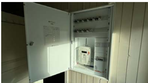
Kontroll av el-skap og kursfortegnelse.
