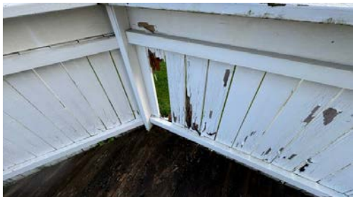
Det er råteskader i rekkverk.
