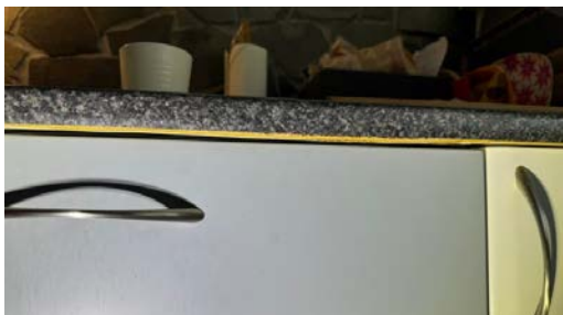
Fuktsvill i benkeplate.
