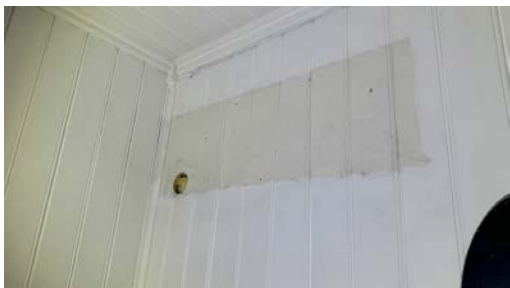
Merker etter varmpumpe på veggen i stuen.
