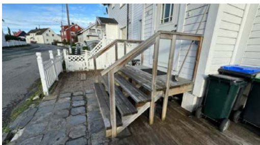
Nærmere undersøkelser angående fallforhold på terrenget under terrassen anbefales.
