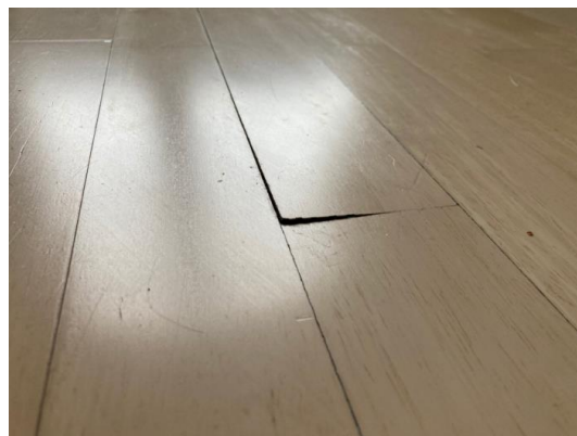
Laminatgulv har skader.
