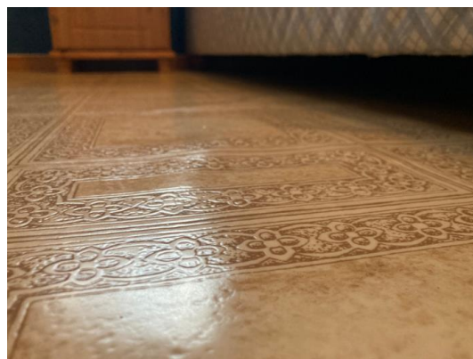
Belegg har sluppet fra underlaget.
