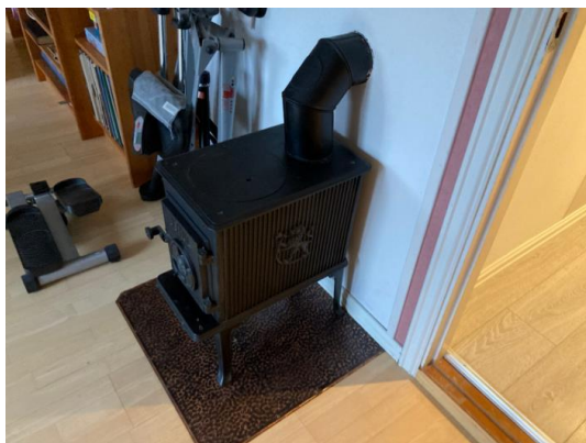
Vedovn i loftetasje har sikkerhetsmangler.
