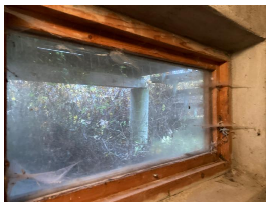
Kjellervinduer har noe slitasje.
