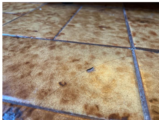
Sprekker i fliser.
