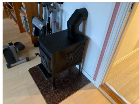
Vedovn i loftetasje har sikkerhetsmangler.
