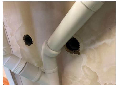
Gjennomføringer i vegg er ikke tettet.
