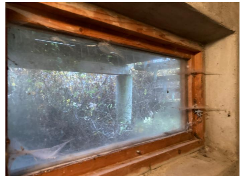
Kjellervinduer har noe slitasje.
