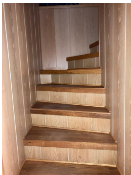
Trapp mellom 1.etasje og kjelleretasje uten håndløpere.
