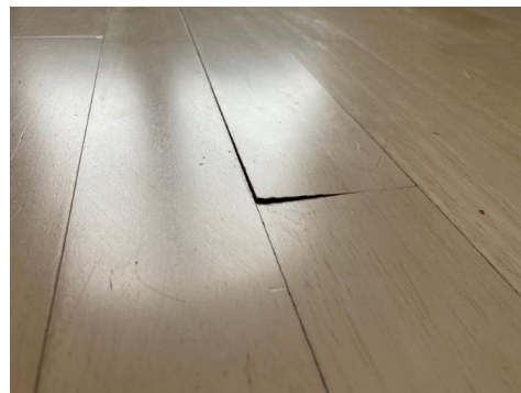
Laminatgulv har skader.
