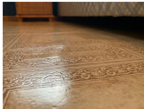
Belegg har sluppet fra underlaget.
