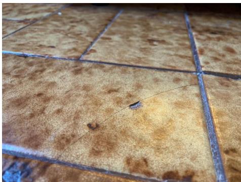
Sprekker i fliser.
