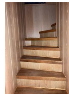
Trapp mellom 1.etasje og kjelleretasje uten håndløpere.
