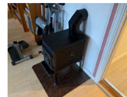
Vedovn i loftetasje har sikkerhetsmangler.
