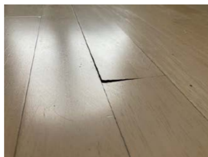
Laminatgulv har skader.
