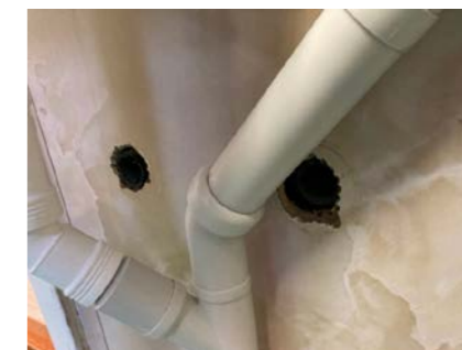
Gjennomføringer i vegg er ikke tettet.
