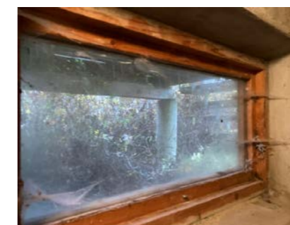
Kjellervinduer har noe slitasje.
