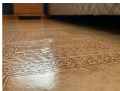
Belegg har sluppet fra underlaget.
