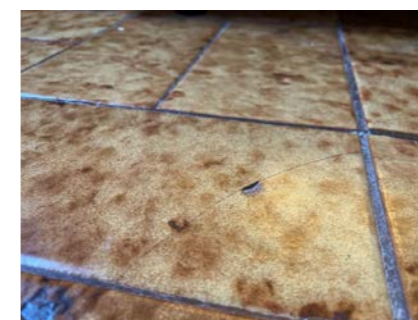
Sprekker i fliser.
