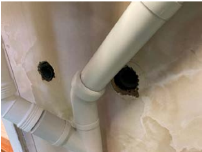
Gjennomføringer i vegg er ikke tettet.
