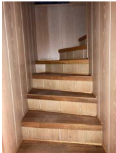
Trapp mellom 1.etasje og kjelleretasje uten håndløpere.
