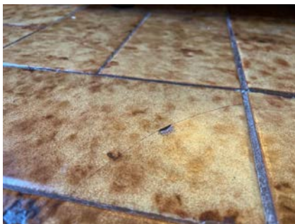
Sprekker i fliser.
