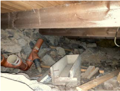
Bygningsavfall på grunn.
