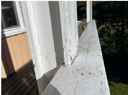
Dekkbord til søyler bør utbedres.
