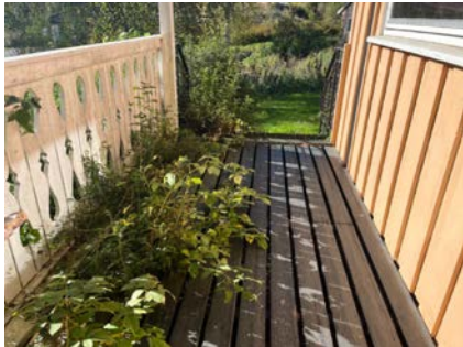
Vegetasjon bør fjernes fra veranda 1.etasje.
