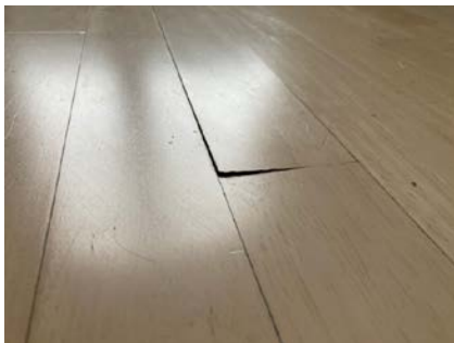
Laminatgulv har skader.
