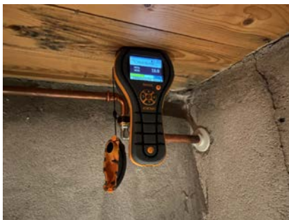
Fuktmåling i himling viste 18 %, som er i grenseland for skadelig fukt.
