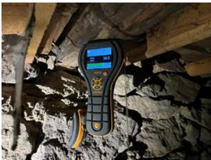
Fuktmåling i himling viste 16 %, som er i grenseland for skadelig fukt.
