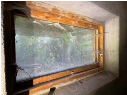
Kjellervinduer må vedlikeholdes.
