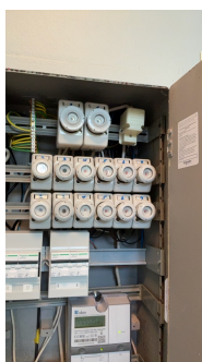
Sikringskap i fellesgang utenfor entredør
