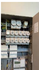
Sikringsskap i fellesgang utenfor entredør
