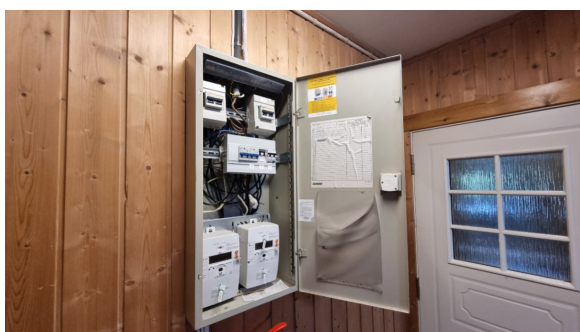
Overbelastningsvern og måler plassert i felles skap i trappeoppgang.
