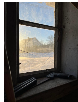
Kjellervindu med sprukket glass.
