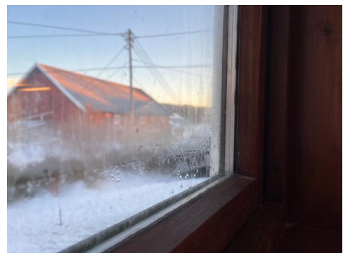
Vindu på bad 1. etasje har punktert glass.
