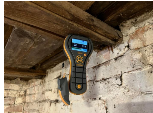
Bjelker med eldre råteskade, normal fukt.
