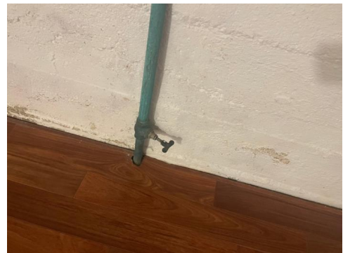
Stoppekran i kjeller.
