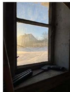
Kjellervindu med sprukket glass.
