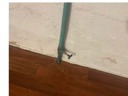
Stoppekran i kjeller.
