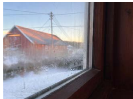
Vindu på bad 1.etasje har punktert glass.
