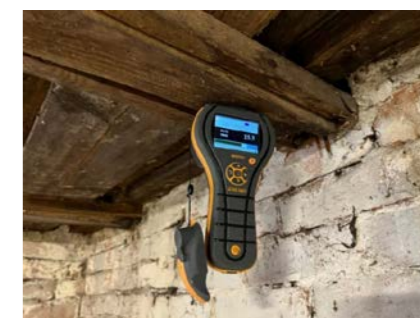
Bjelker med eldre råteskade, normal fukt.
