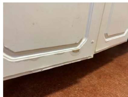
Fuktskader på skapfronter.
