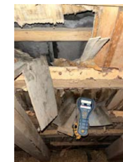
Eldre undertak har skader og høy fuktighet.
