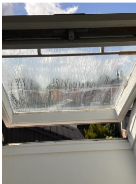
Punktert glass og råteskade i karm.
