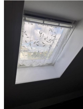
Takvindu i bad lar seg ikke åpne og er utett/råteskadet
