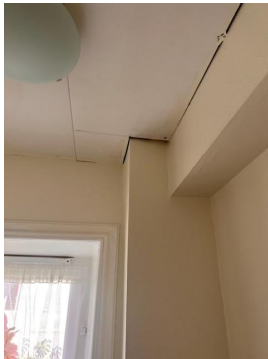
Taklister mangler i toalett 1 etg.
