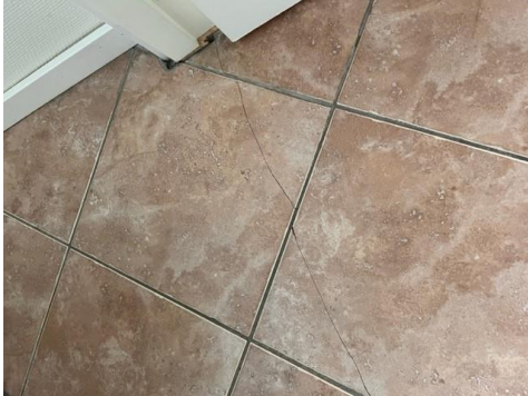
Sprekker i gulvfliser 1 etg.
