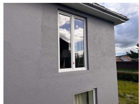
Balkongdør uten sikring mot terreng.
