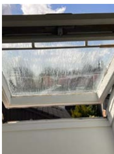
Punktert glass og råteskade i karm.
