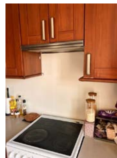
Kjøkkenvifte er montert for høyt.
