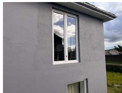
Balkongdør uten sikring mot terreng.
