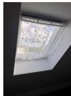
Takvindu i bad lar seg ikke åpne og er utett/råteskadet
