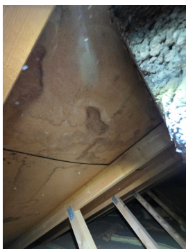
Fuktskjolder i undertak ved pipegjennomføring
