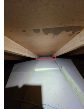
Begrenset ventilering av konstruksjon
