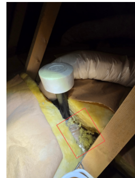
Det er flere felter som mangler isolasjon
