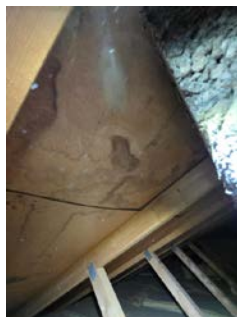
Fuktskjolder i undertak ved pipegjennomføring
