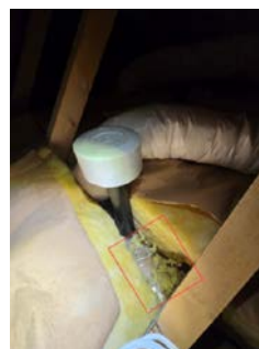
Det er flere felter som mangler isolasjon
