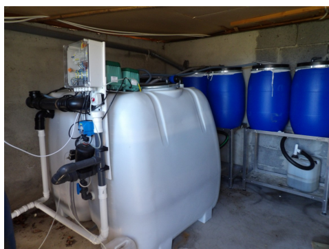
BioVac anlegg i kjeller.
