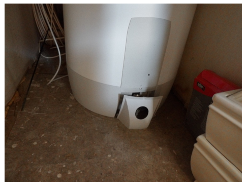
Løst deksel til varmtvannsbereder.
