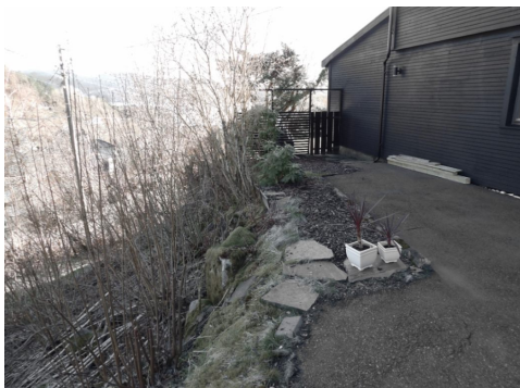
Det mangler sikring mot terreng på tomten.
