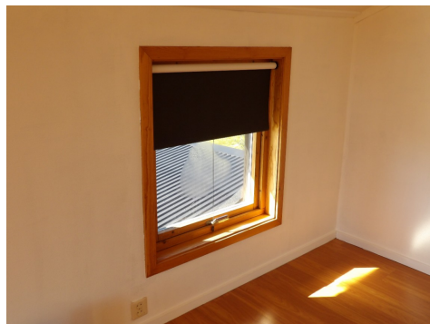
Punktert glass i vindu.
