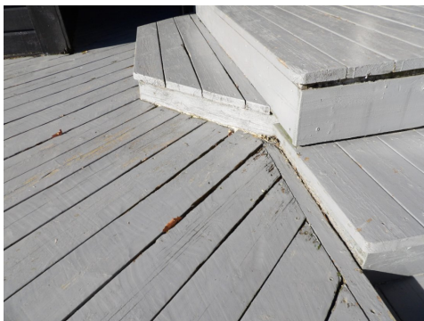
Slitasje på tredekke.
