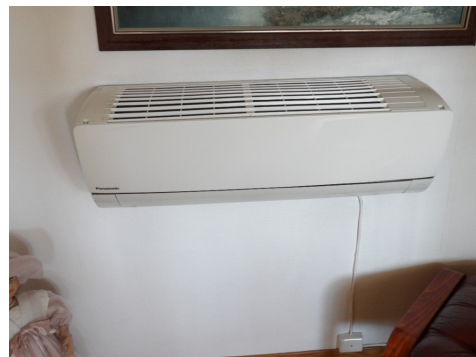
Varmepumpe i stue.
