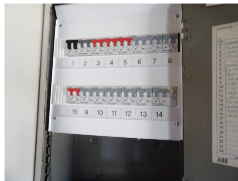
Sikringsskap på kontor.
