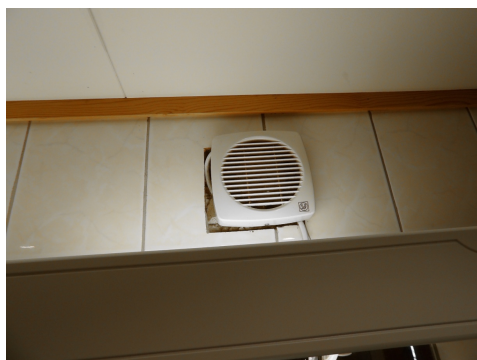
Ikke tett rundt mekanisk vifte.
