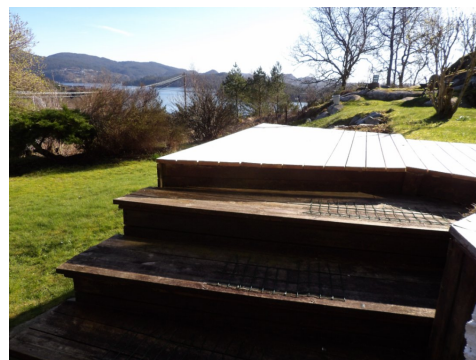
Utvendige tretrapper uten sikring mot fall.
