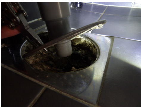
Plastsluk på vaskerom.
