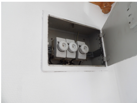
Inntakssikringer ved trapp i stue.
