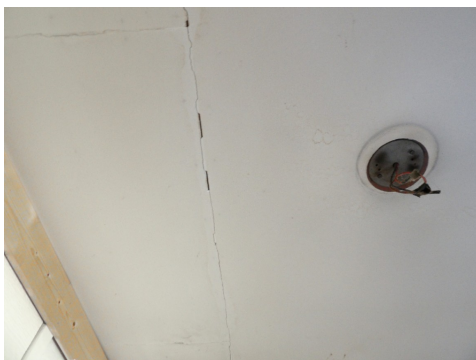
Noe oppsprekk i overflater.
