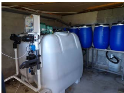
BioVac anlegg i kjeller.
