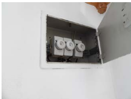
Inntakssikringer ved trapp i stue.
