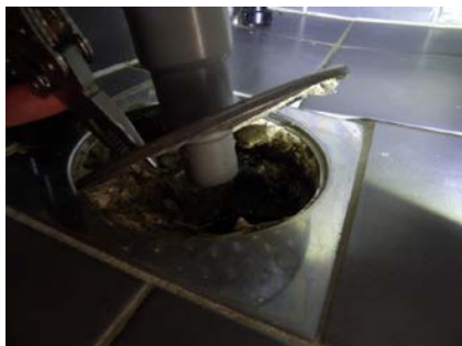
Plastsluk på vaskerom.
