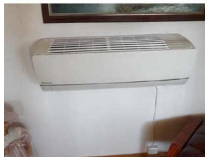
Varmepumpe i stue.
