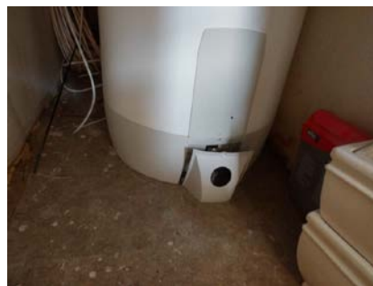
Løst deksel til varmtvannsbereder.
