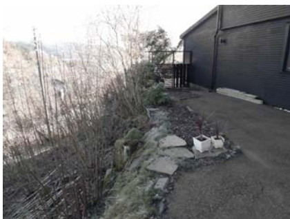
Det mangler sikring mot terreng på tomten.
