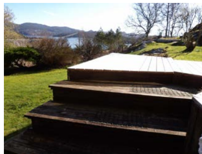
Utvendige tretrapper uten sikring mot fall.
