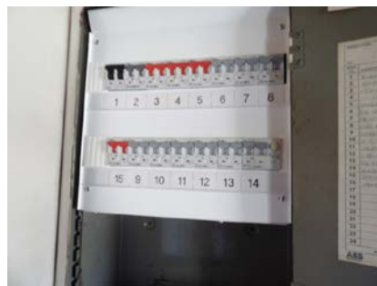
Sikringsskap på kontor.
