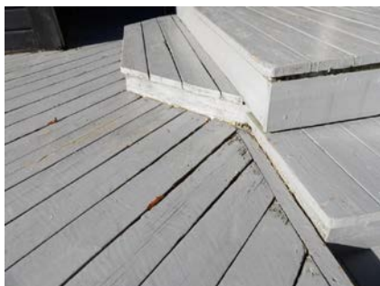
Slitasje på tredekke.
