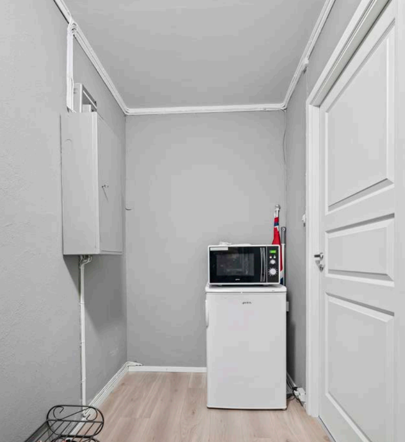
Del av bod i leiligheten - Sikringsskap med nye sikringer
