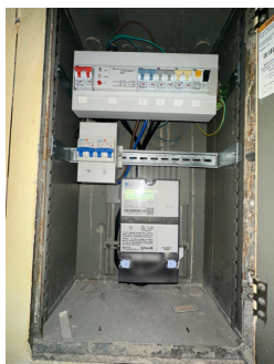
Sikringsskap plassert i felles oppgang.
