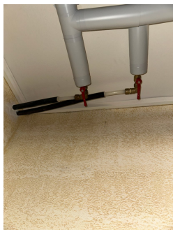
Stoppekran plassert i felles gang
