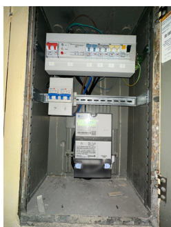
Sikringsskap plassert i felles oppgang.
