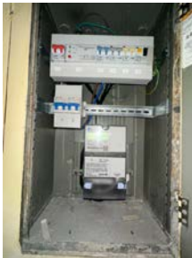
Sikringsskap plassert i felles oppgang.
