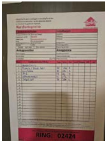
Sikringsskap plassert i felles oppgang.
