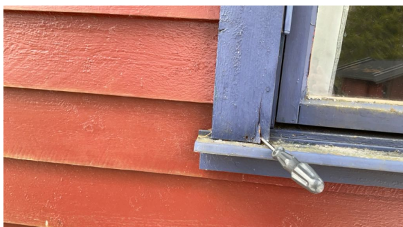
Råteskader på utvendig belistning registrert.
