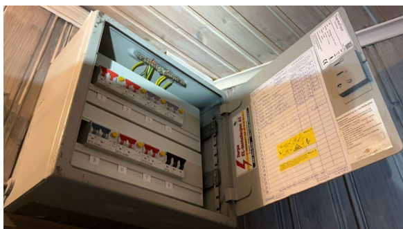
Sikringsskap er plassert i entrèområdet.
