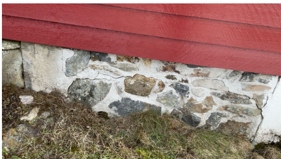
Sprekker i murt område mellom pilarer.
