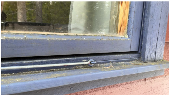
Vinduer bærer preg av slitasje.
