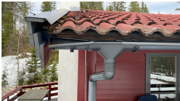
Deformasjoner på takrenner.
