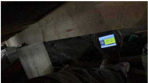
Enkle fuktmålinger viste risikable verdier for fukt i drager under bygningen.
