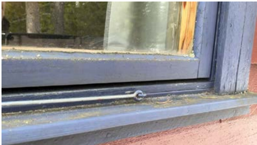
Vinduer bærer preg av slitasje.
