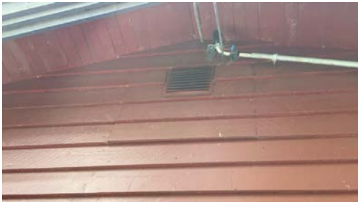
Manglende stige på befaringsstidspunktet. Kaldtloft er derfor ikke inspisert.
