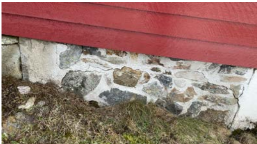
Sprekker i murt område mellom pilarer.
