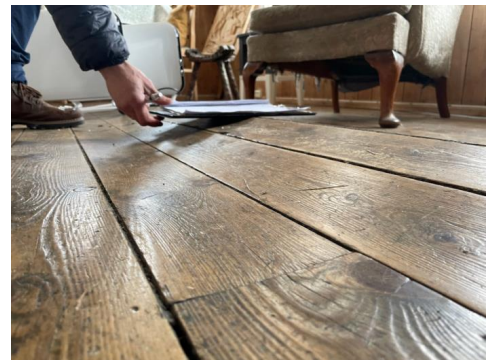
Eksempel på skade i gulv
