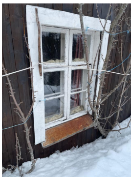
Synlig fukt og råteskader i vinduer.
