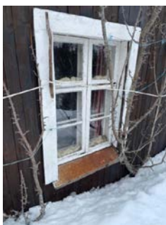
Synlig fukt og råteskader i vinduer.
