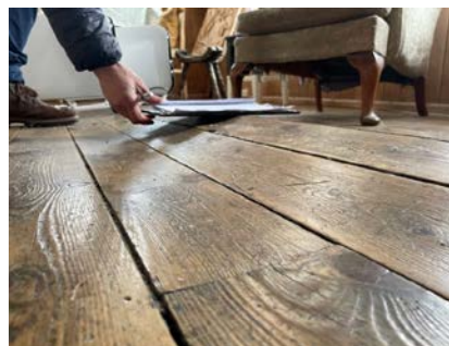
Eksempel på skade i gulv
