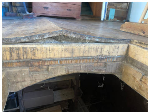
Skade i gulv på kjøkken
