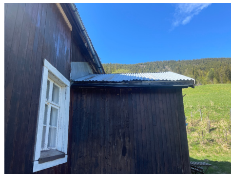
Synlig bulker og avvik på plater
