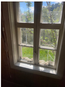
Synlige fuktmerker grunnet kondens
