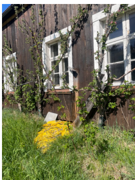
Lav høyde mellom trekledning og terreng
