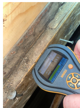
Det måles høye fuktverdier i treverk.
