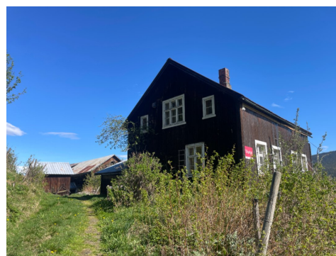
Deformasjoner i takrenner og manglende nedløp
