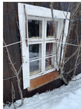
Synlig fukt og råteskader i vinduer.
