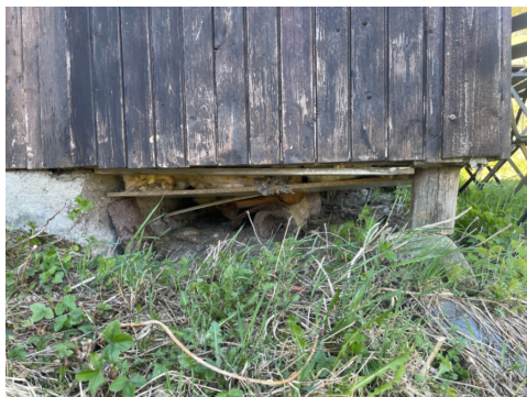
Synlige skader i stubbeloft.
