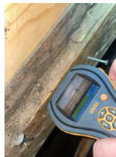
Det måles høye fuktverdier i treverk.
