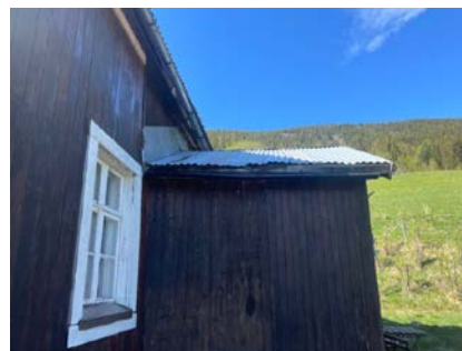
Synlig bulker og avvik på plater
