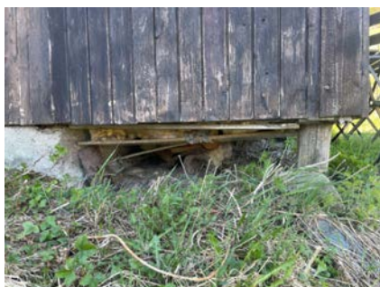
Synlige skader i stubbeloft.
