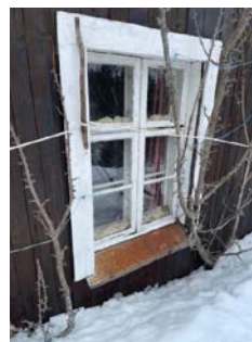
Synlig fukt og råteskader i vinduer.
