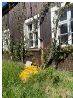
Lav høyde mellom trekledning og terreng
