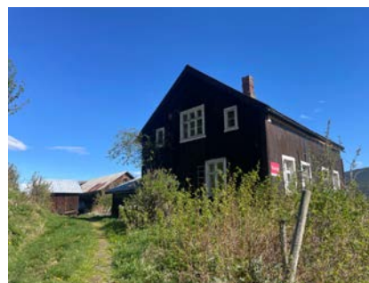
Deformasjoner i takrenner og manglende nedløp
