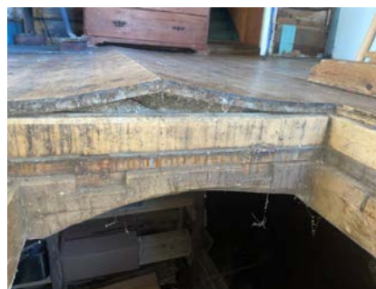
Skade i gulv på kjøkken
