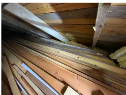
Lufting/ventilering bør forbedres.
