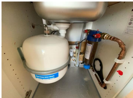
Stoppekran montert under kjøkkenbenk.
