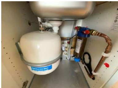
Stoppekran montert under kjøkkenbenk.
