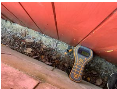
Råteskadet kledning mot nordøst. Ved enkel fuktmåling registrerte jeg fukt.
