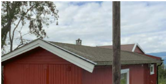
Taktekking er delvis mosegrodd mot nord.
