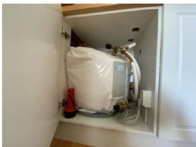
Varmtvannsbereder montert i kjøkkenbenk.
