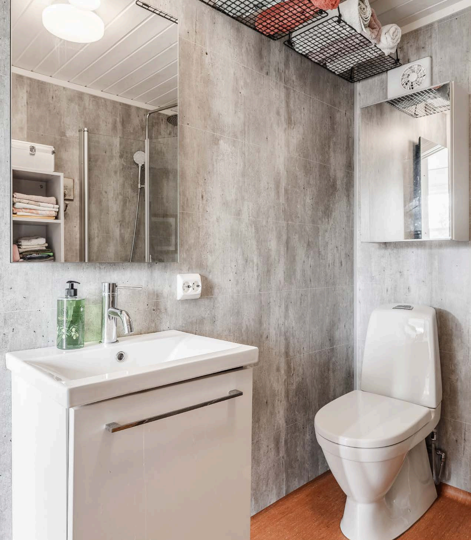
Vegghengt servant med skaplass. Installert baderomsvifte.
