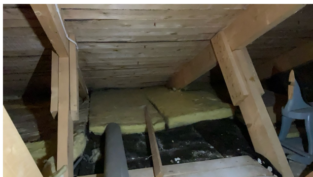
Isolasjon for langt ut i raftekassen.
