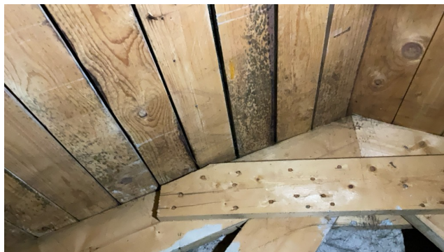
Svertesopp rundt pipe.
