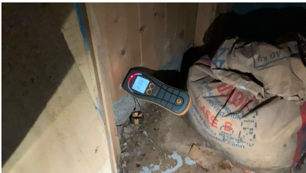
Fuktmålinger utført i panel på bod bak innredet rom.
