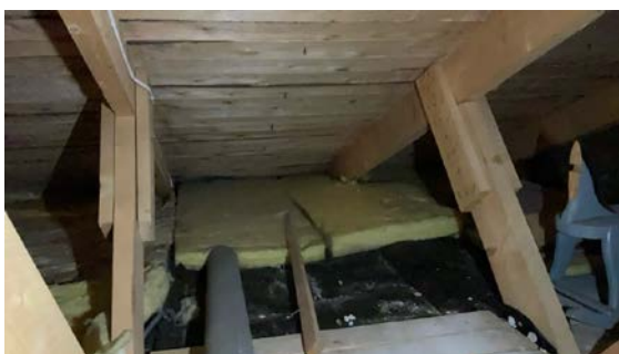
Isolasjon for langt ut i raftekassen.
