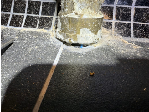
Ingen membran rundt rørgjennomføring, feil utførelse
