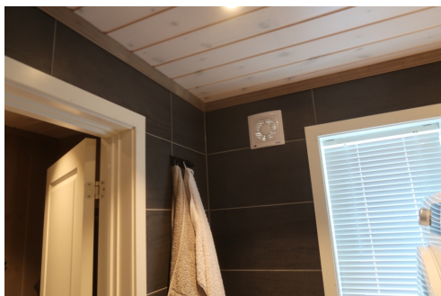
Bilde viser avtrekksvifte som bør festes bedre
