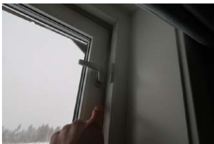
Bilde viser hvor vinduet er i konflikt med karm
