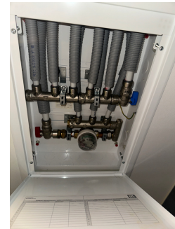
Samleskap med rørkurser og stoppekraner
