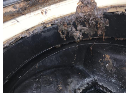
Fare for utett overgang sluk/ membran. Bør undersøkes nærmere.
