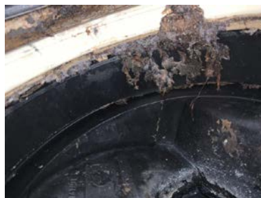
Fare for utett overgang sluk/ membran. Bør undersøkes nærmere.
