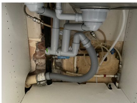
Plastrør under kjøkkenbenk.
