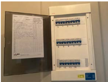
Sikringsskap i entre'/gang
