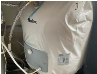
Varmtvannsbereder i kjøkkenbenk.
