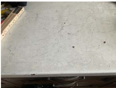
Skap under vask har svell skader.
