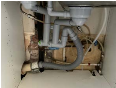
Plastrør under kjøkkenbenk.
