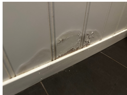
Fuktskade på veggplater i gang 1. etg
