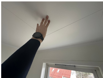
Løs takplate, soverom 2 etg.
