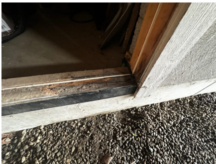
Dørterskel til teknisk rom
