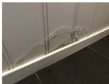
Fuktskade på veggplater i gang 1. etg
